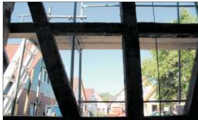
Durch die geöffnete Westseite der jüdischen Schule ist ein Blick auf einen Abschnitt der Goeben- und Wilhelmstraße möglich.
